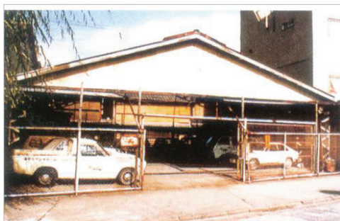
写真8 修理前のガレージ—祇園新橋 出典:京都市都市計画局『京の伝統的建造物群保存地区』(2000)
